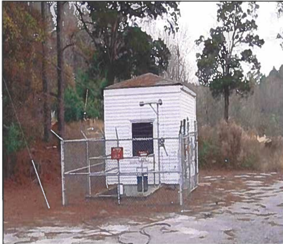
Carolina Springs Liftstation
